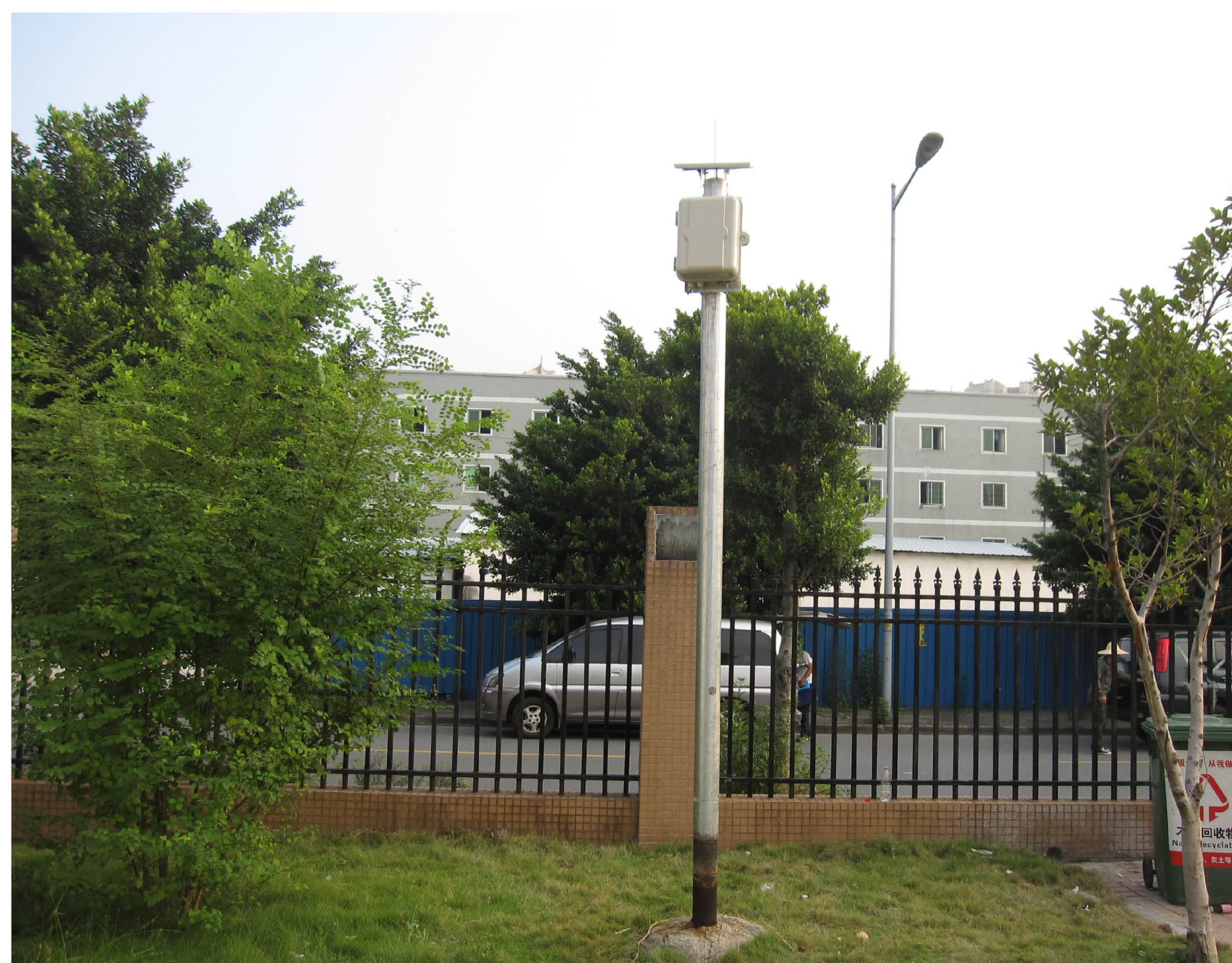
安装在现场的岩溶塌陷动力监测系统 (广州金沙洲)
