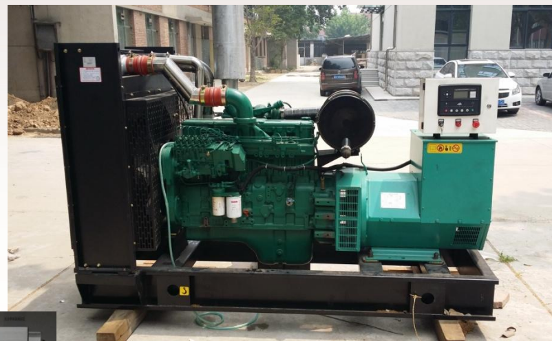
200KW 发电机组 (200KW generator set)
